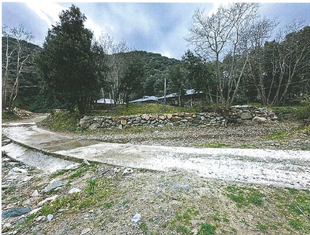
Εικόνα 14- Τμήμα υφιστάμενου τοιχίου ξερολιθιάς προς αποκατάσταση
