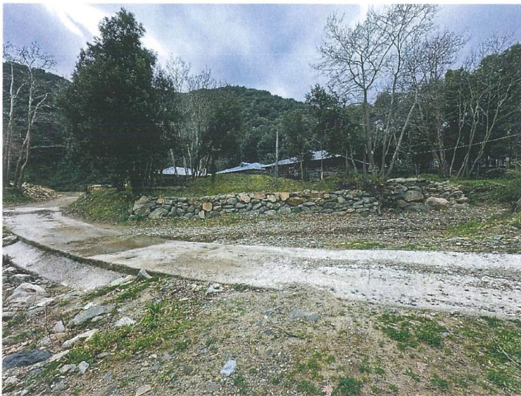
Εικόνα 18. Τμήμα υφιστάμενου τοιχίου ξερολιθιάς προς αποκατάσταση
