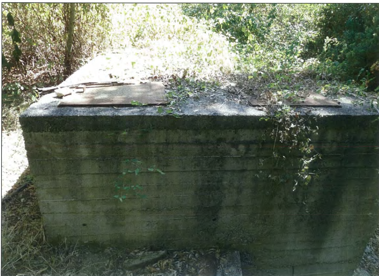
Φωτ. 4 : Φρεάτιο υδροληψίας στη θέση του ρέματος.
