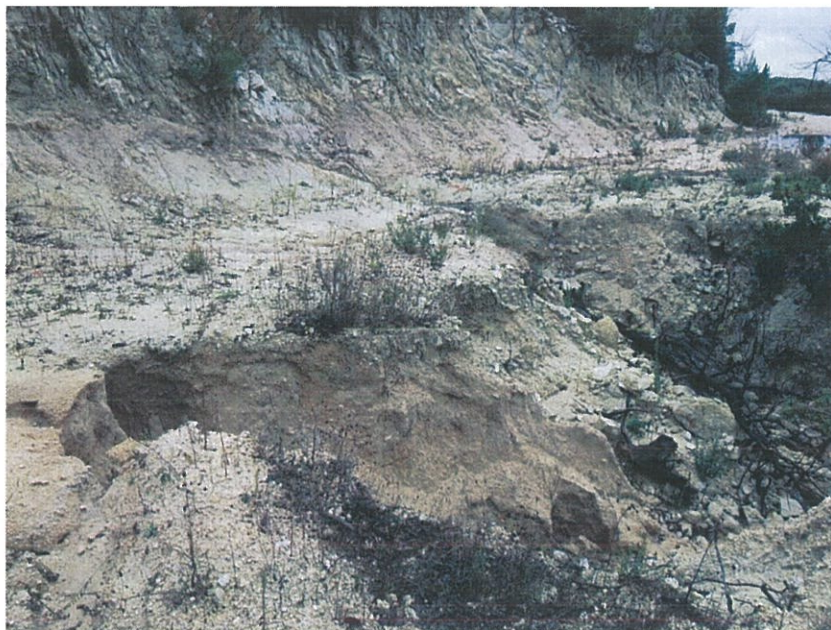
Εικόνα 3. Τμήμα δασικού δρόμου με διάβρωση καταστρώματος
