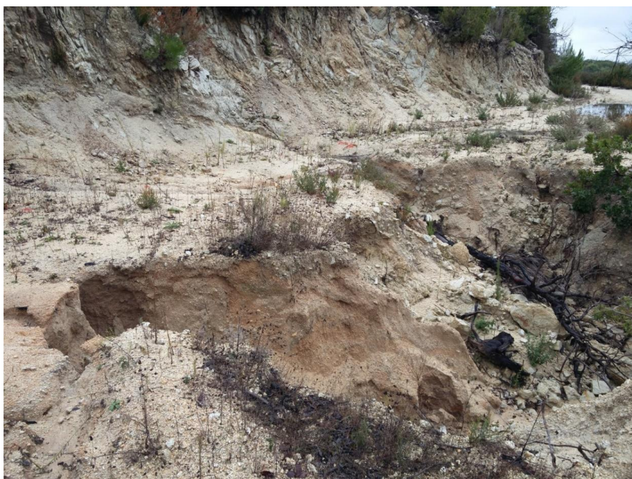
Εικόνα 1. Τμήμα δασικού δρόμου με διάβρωση καταστρώματος
