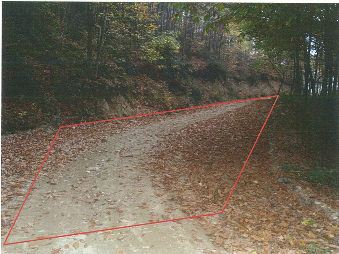
Φωτογραφία 6: Τεχνικό έργο 7 (ρείθρο). Το τεχνικό απαγει τα επιφανειακά ύδατα του δρόμου και του υπερκείμενου ρέματος και τα οδηγεί στα κατάντη.
