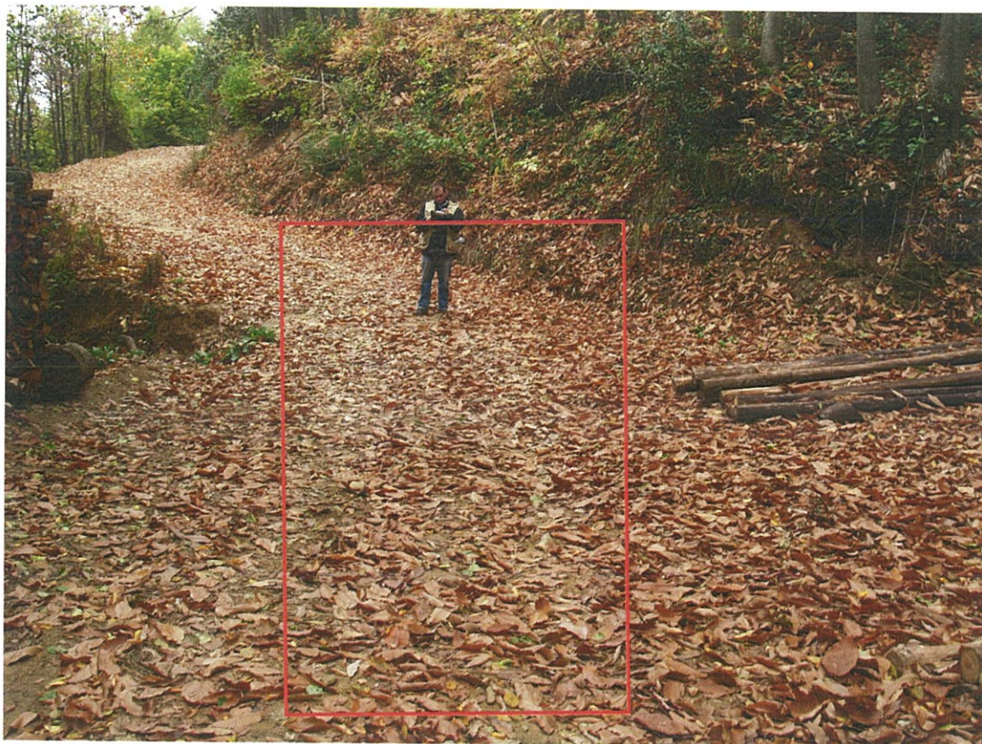
Φωτογραφία 15: Τεχνικό έργο 29 (Ρεϊθρο). Το τεχνικό απάγει τα επιφανειακά ύδατα και του δρόμου και του υπερκείμενου ρέματος και τα οδηγεί στα κατάντη.
