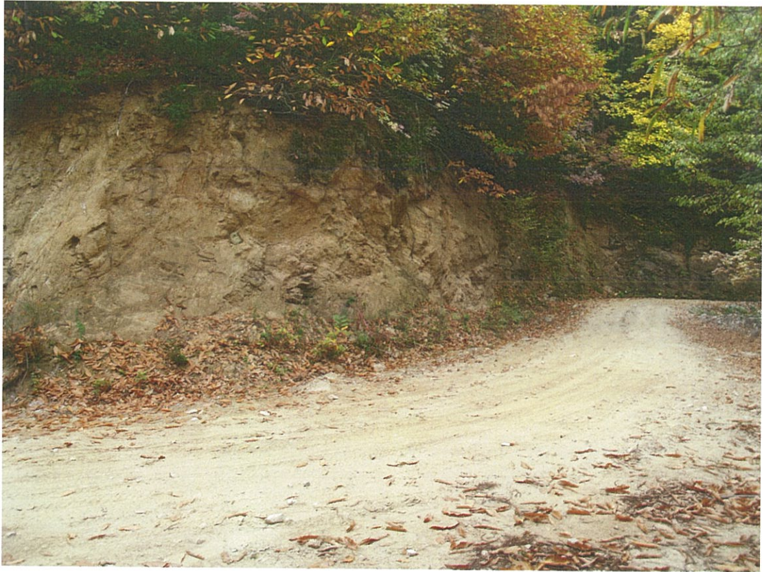
Φωτογραφία 3: Τέταρτη χωματουργική παρέμβαση (X4). Διαφάνεται η μικρή ακτίνα καμπυλότητας καθώς και το βραχώδες της περιοχής.
