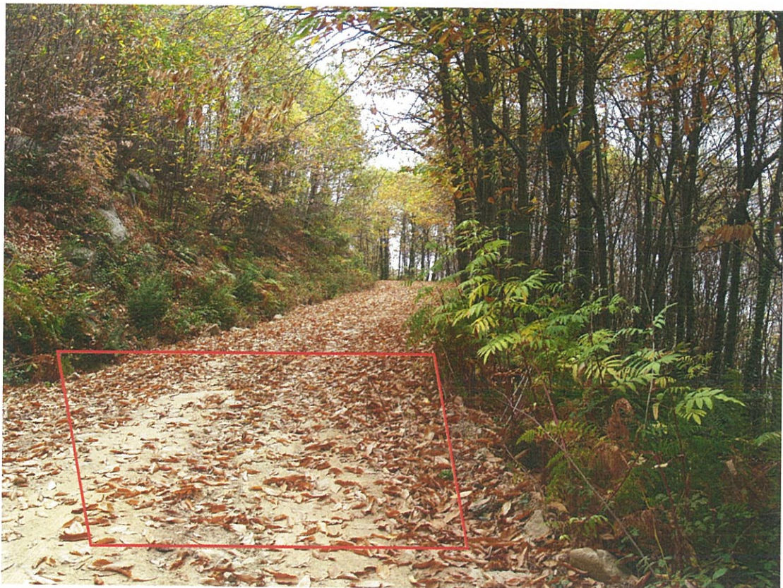
Φωτογραφία 12: Τεχνικό έργο 23 (Ρεϊθρο). Το τεχνικό απάγει τα επιφανειακά ύδατα και του δρόμου και του υπερκείμενου ρέματος και τα οδηγεί στα κατάντη.
