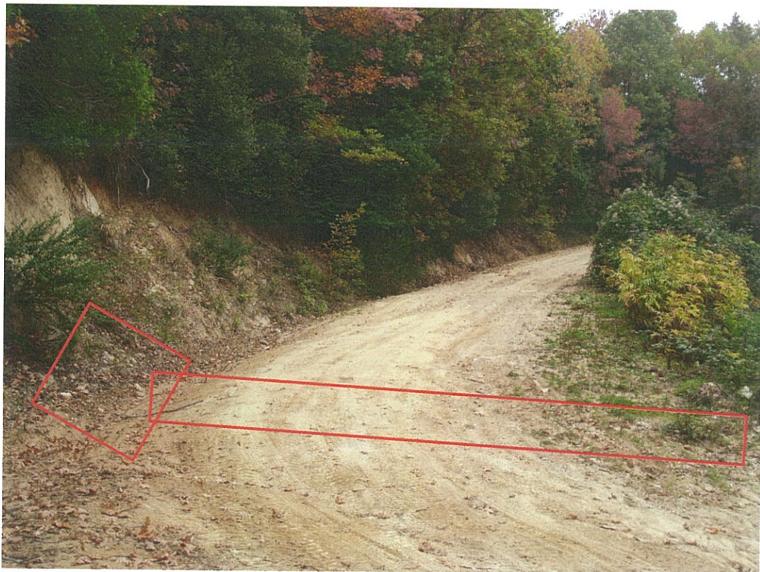
Φωτογραφία 8: Τεχνικό έργο 11 (Σωληνωτός οχετός). Το τεχνικό απάγει τα επιφανειακά ύδατα του δρόμου και τα οδηγεί στα κατάντη.
