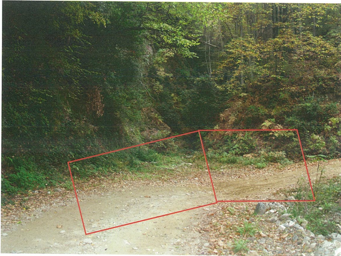
Φωτογραφία 7: Τεχνικό έργο 9 (ρείθρο). Το τεχνικό απάγει τα επιφανειακά ύδατα του δρόμου και του υπερκείμενου ρέματος και τα οδηγεί στα κατάντη.
