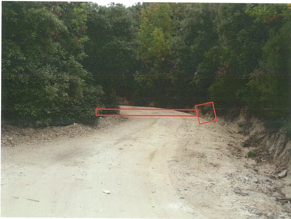
Φωτογραφία 9: Τεχνικό έργο 14 (Σωληνωτός οχετός). Το τεχνικό απάγει τα επιφανειακά ύδατα και από τις δύο κατευθύνσεις του δρόμου και τα οδηγεί στα κατάντη.
