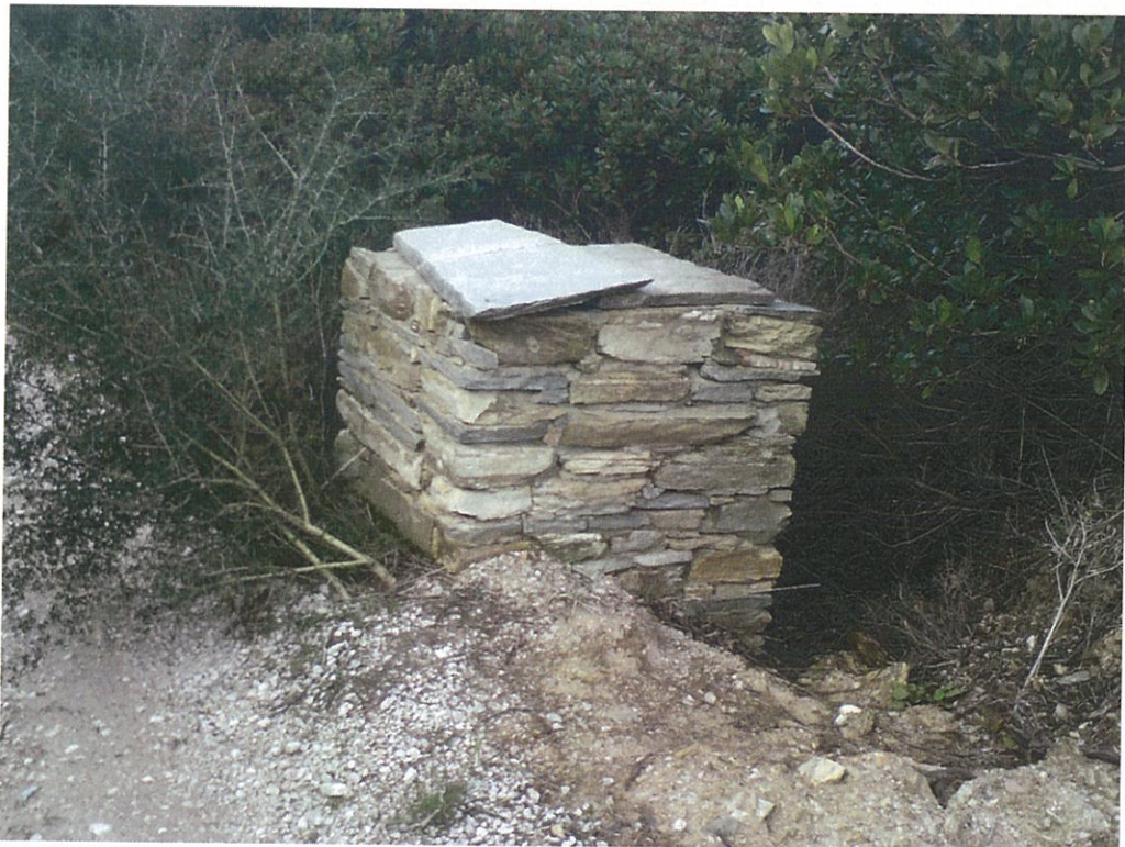
Φωτογραφία 6: Φρεάτιο ηλεκτροδότησης αντλίας. Δτ Α'8.
