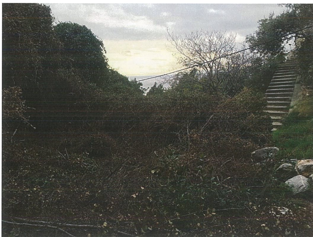
Εικ.2. Απεικόνιση του υπό μελέτη τμήματος της κοίτης του χειμάρρου, από διατομή 5 έως διατομή 6, επένδυση με συρματοκιβώτια (T2)
