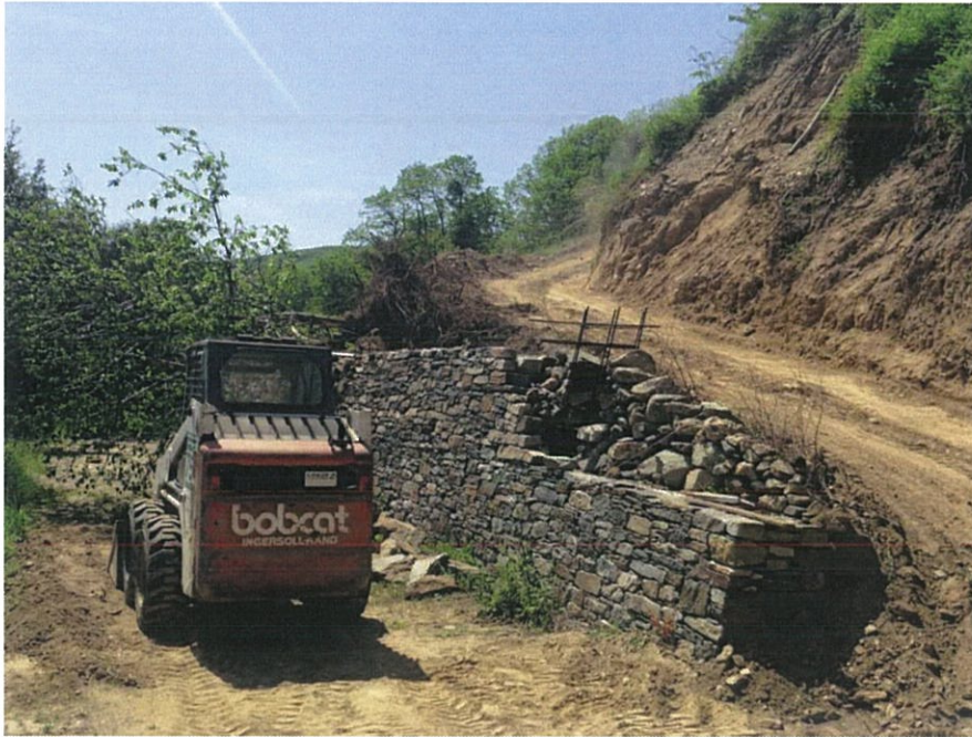
Εικ.15: Το πρανές προς τα ανατολικά του Κελλιού μετά τις πρώτες προσπάθειες επαναδιάνοιξης των μονοπατιών κίνησης. Παρατηρεί κανείς την έντονη αλλοίωση που υπέστη το πρανές (δεξιά στη φωτογραφία) και την άμεση ανάγκη κατασκευής βαθμιδωτών αναλημματικών τοίχων με σκοπό την αποφυγή μελλοντικών προβλημάτων ως προς την ασφάλεια και την προσβασιμότητα του Κελλιού. Διακρίνεται επίσης (στο κέντρο) η καταστροφή τμήματος προϋπάρχοντος αναλημματικού τοίχου.
