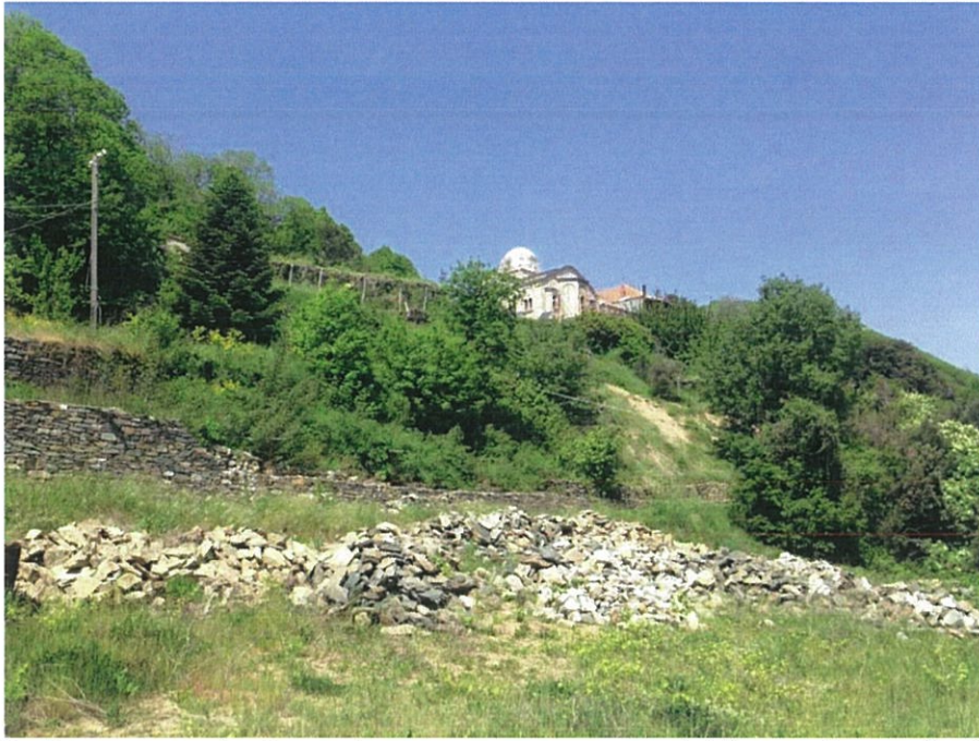
Εικ.17: Το έντονο ανατολικό πρανές σε μια χαρακτηριστική λήψη από ανατολικά προς τα δυτικά. Η βαθμιδωτή αντιστήριξη κρίνεται ως προς η πλέον ενδεδειγμένη λύση για την αποφυγή κατολισθήσεων. Ο ημιτελής αναλημματικός τοίχος που διατρέχει γραμμικά το μέσο της φωτογραφίας, θα αποτελεί το κατώτερο μέρος ενός συνόλου τεσσάρων έως έξι παρόμοιων τοίχων που θα «αγκαλιάζουν» το έντονο πρανές.
