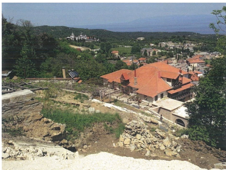
Εικ.2: Το πρανές δυτικά του Κελλιού. Οι καταστροφές από τις καθιζήσεις και κατολισθήσεις λόγω των έντονων βροχοπτώσεων, επιβάλλουν άμεσα την αποκατάσταση των ζημιών για την τωρινή αλλά και τη μελλοντική προστασία του κτιριακού συγκροτήματος του Κελλιού – καθώς και του νέου Ιερού Ναού του Οσίου Νικοδήμου του Αγιορείτου – που διακρίνονται στο μέσο της εικόνας. Στο βάθος χαμηλά αναπτύσσονται οι Καρνές.
