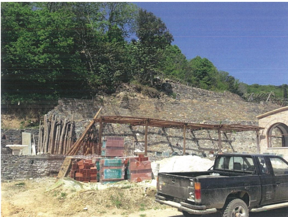
Εικ.8: Υφιστάμενος αναληματικός τοίχος που υπέστη σοβαρότατες αλλοιώσεις λόγω της μετατόπισης χωμάτινων μαζών (εξαιτίας των έντονων βροχοπτώσεων).
