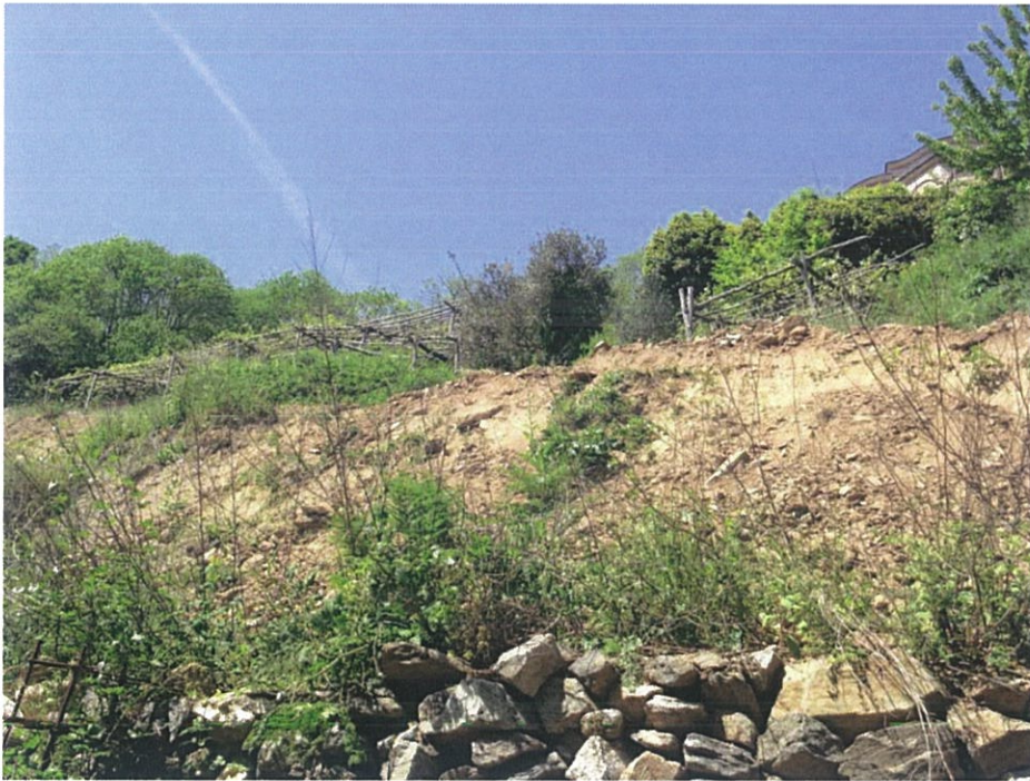
Εικ.16: Το έντονο ανατολικό πρανές (λήψη από χαμηλά) όπου κρίνεται άμεση η λήψη μέτρων αντιστήριξης.
