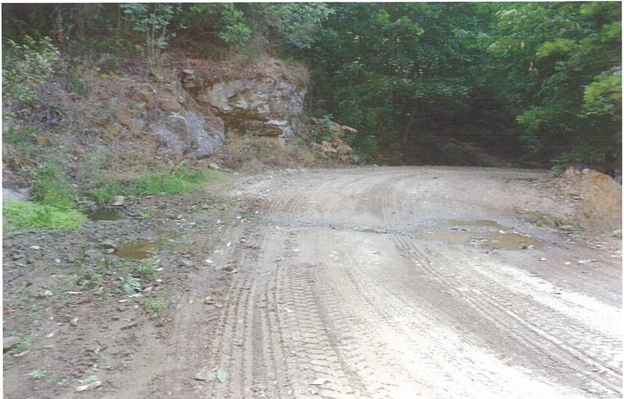
Εικόνα 3.4 Απεικόνιση της δασικής οδού "Μοναστήρι-Σπηλιά Αγ. Διονυσίου", στη θέση κατασκευής του τεχνικού (T20)
