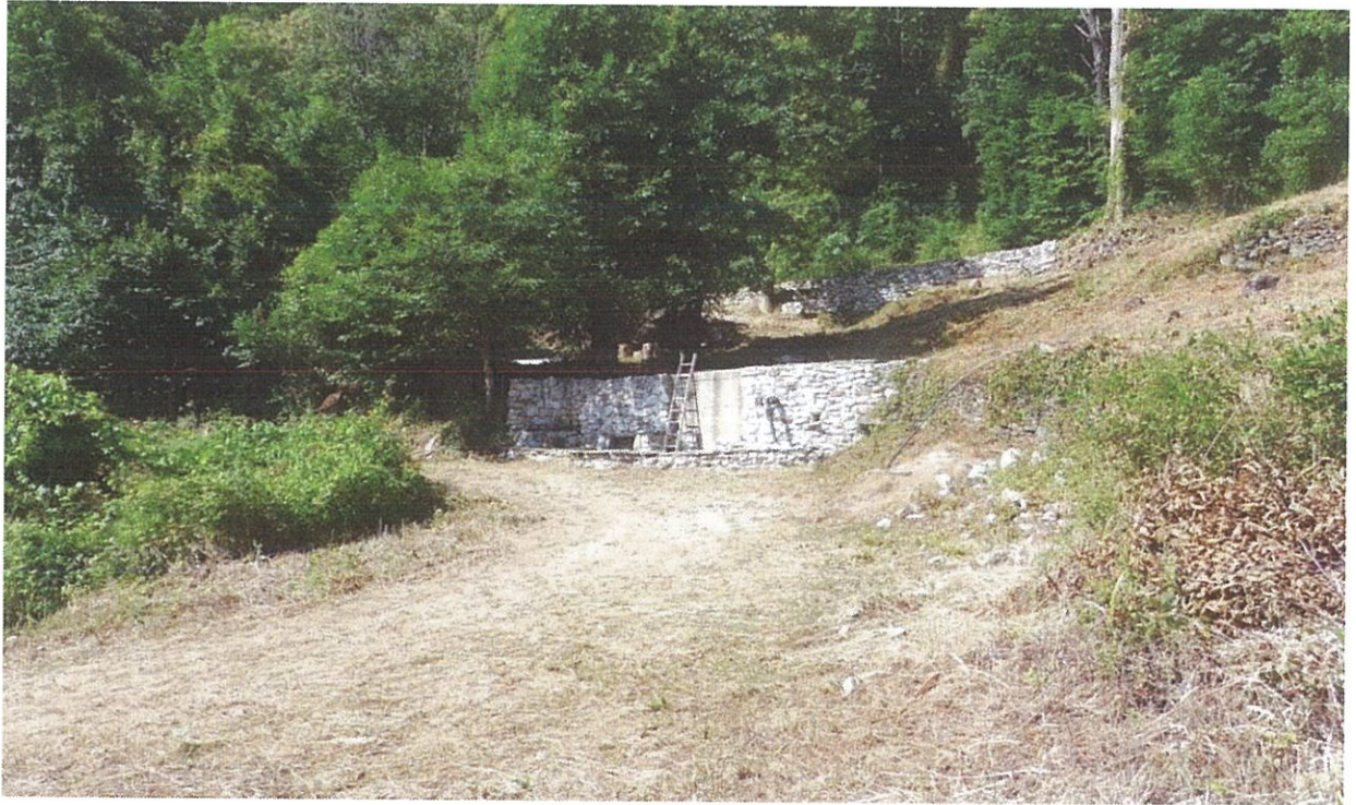
Εικόνα 17: Απεικόνιση της δεξαμενής στην θέση «Ι.Κ. Ευαγγελισμού», όπου συγκεντρώνεται το νερό από τις τρεις τοπικές πηγές, και εν συνεχεία μέσω του νέου αγωγού ονομαστική διάμετρο Φ63 καταλήγει σε νέα δεξαμενή στη θέση «Ι.Κ. Αγίου Ιωάννη Χρυσοστόμου».
