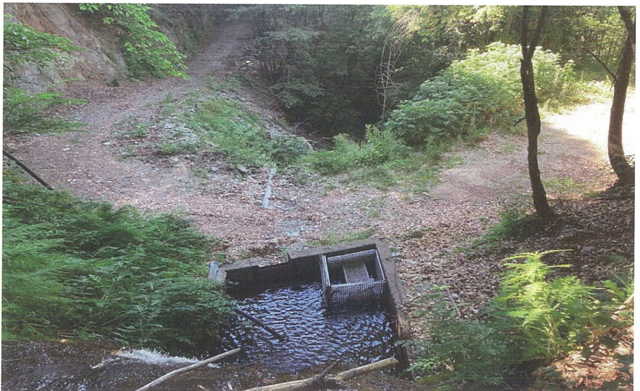
Εικόνα 12: Γενική άποψη της υδατοσυλλογής στη θέση «Γουρνούδες» αφετηρία υφιστάμενου δικτύου αγωγών, με ονομαστική διάμετρο \Phi 160 .
