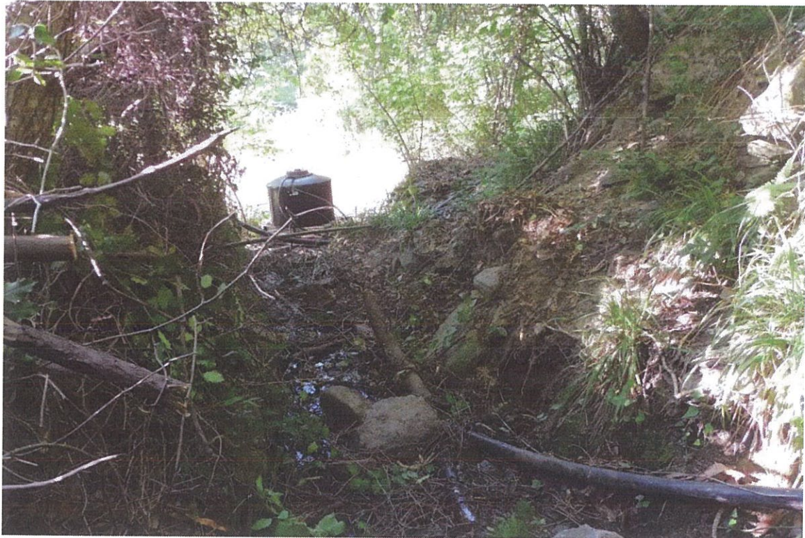
Εικόνα 14: Απεικόνιση της πλαστικής δεξαμενής στην θέση «Ι.Κ. Ευαγγελισμού», από συγκεντρώνονται το νερό από τις δύο τοπικές πηγές (δυτική και βορινή), και εν συνεχεία μέσω του νέου αγωγού ονομαστική διάμετρο \Phi 63 καταλήγει σε κτιστή δεξαμενή χωρητικότητας 25κ.μ. στη θέση «Ι.Κ. Ευαγγελισμός».
