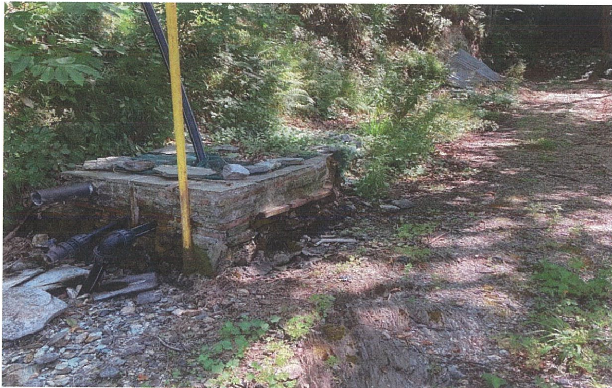
Εικόνα 10: Γενική άποψη των πηγών στη θέση «Γουρνούδες» αφετηρία του νέου αγωγού «Γουρνούδες – Ευαγγελισμός – Νέα Δεξαμενή», με ονομαστική διάμετρο Φ90 και μήκους L=4+164,69 χλμ.
