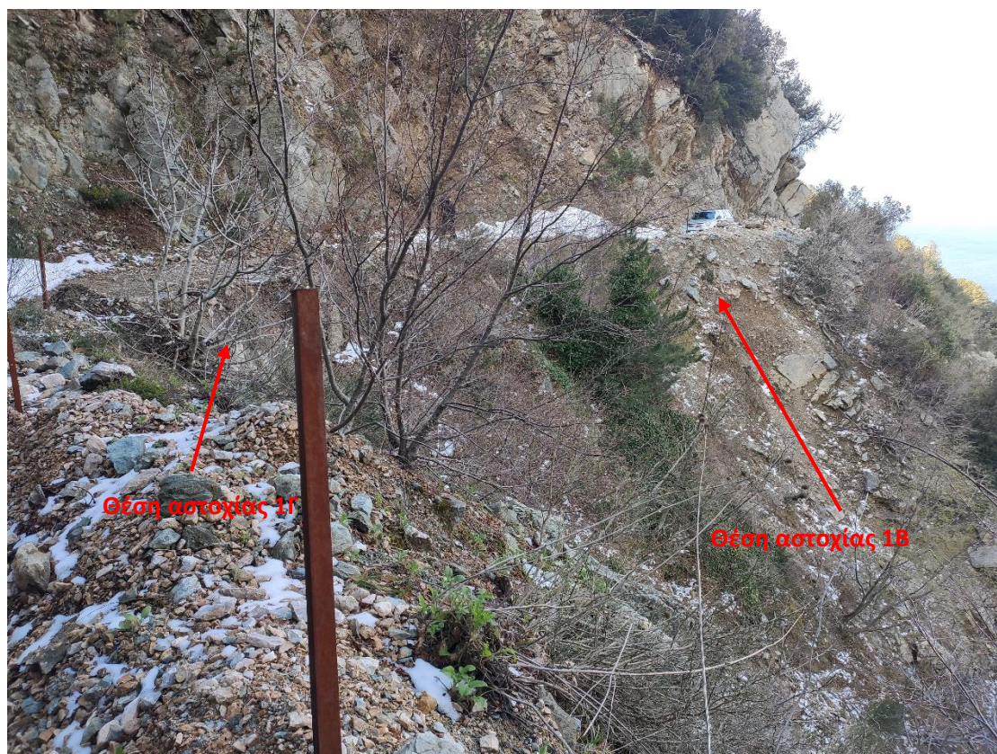
Εικόνα 18: Θέσεις αστοχίας 1Β και 1Γ.
